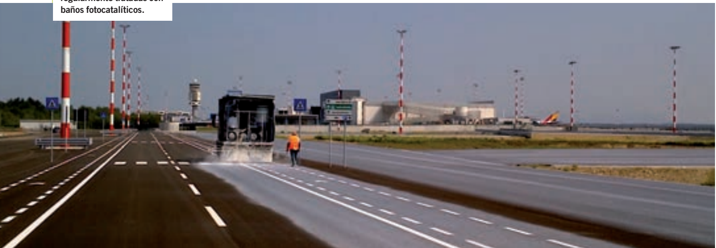
Las pistas del aeropuerto milanés de Malpensa son regularmente tratadas con baños fotocatalíticos.
